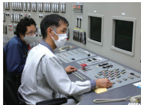
運転再開時の制御室の様子
